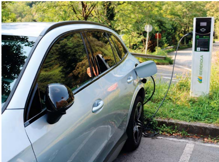
Auto elektrikoentzako kargalekua Azitaingo industrialdean (Eibar). DKT
